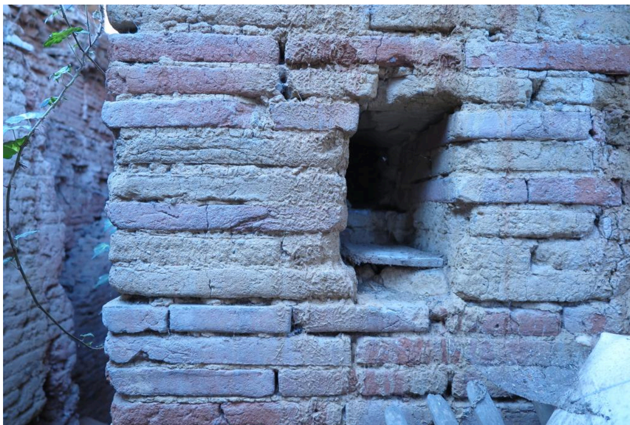
Niche située sur le côté droit de la porte d'enfournement.
