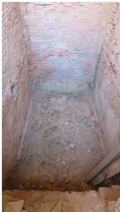
Vue plongeante sur la sole du laboratoire depuis la porte d'enfournement des produits. Phot. Jérôme Bonhôte IVR76_20203100018NUCA
