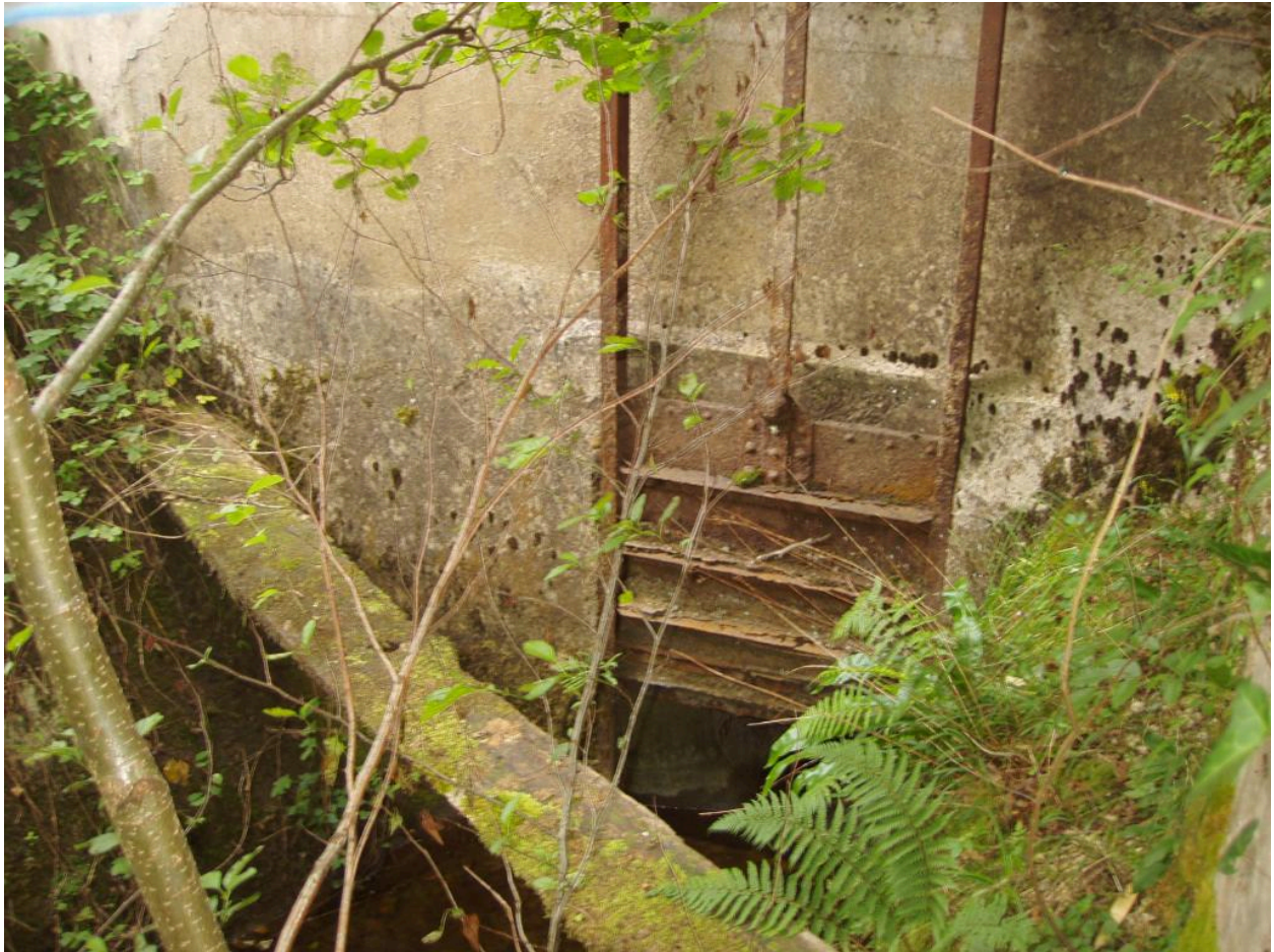
Détail de la vanne sur le canal d'amenée.
