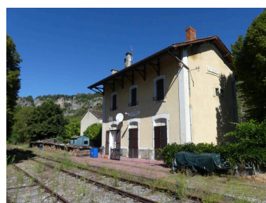
Bâtiment des voyageurs : vue depuis le sud-est. Phot. Guillaume Bernard, Phot. Fabien Cadot IVD46_20204602062NUCA
