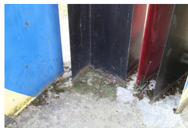
détail de l'oeuvre : implantation des lames d'acier dans le socle de béton Phot. Pauline Bourgasser IVR76_20166501036NUCA
