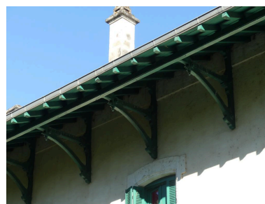
B timent des voyageurs,  levation sud-est : d tail de la charpente. Phot. Guillaume Bernard, Phot. Fabien Cadot IVD46_20204602000NUCA
