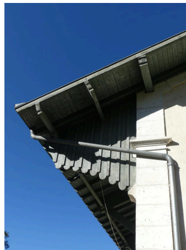
Halles à marchandises, élévation sud-ouest : détail de la charpente. Phot. Guillaume Bernard, Phot. Fabien Cadot IVD46_20204602002NUCA
