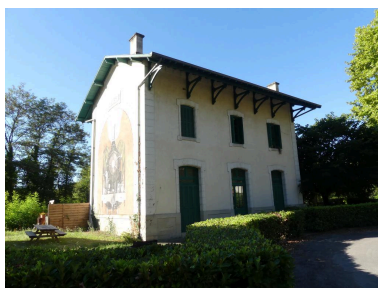
B timent des voyageurs : vue depuis le nord. Phot. Guillaume Bernard, Phot. Fabien Cadot IVD46_20204602021NUCA
