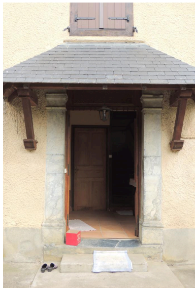
Porte d'entrée avec encadrement en pierre de taille. Phot. Marion Fourcayran IVD65_20136500137NUCA
