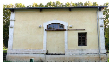
Halles à marchandises : élévation nord. Phot. Guillaume Bernard, Phot. Fabien Cadot IVD46_20204602124NUCA
