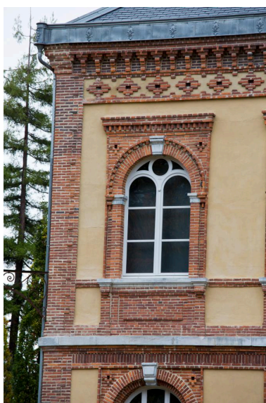
Façade sud sur jardin : baie du premier étage (détail). Phot. Philippe Poitou IVR73_20156550059NUCA
