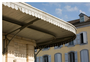
Détail de la marquise et son baldaquin entourant la halle. Phot. Philippe Benoist IVR73_20086501022NUCA
