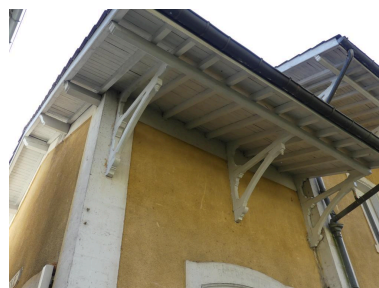
Bâtiment des voyageurs, côté voie ferrée : débord de toiture de la partie nord-est. Phot. Guillaume Bernard, Phot. Fabien Cadot IVD46_20214605584NUCA
