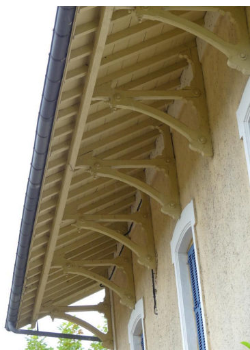
Bâtiment des voyageurs, élévation sud-ouest : aisseillers. Phot. Guillaume Bernard, Phot. Fabien Cadot IVD46_20214605003NUCA
