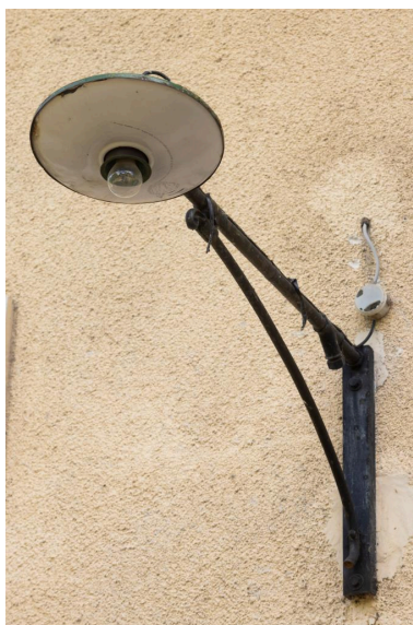
Elévation sur la voie : lampe extérieure. Phot. Amélie Boyer IVR76_20244650190NUCA
