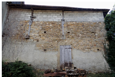
Vue de l'élévation ouest d'une partie des dépendances. Phot. Marion Fourcayran IVD65_20146500495NUCA
